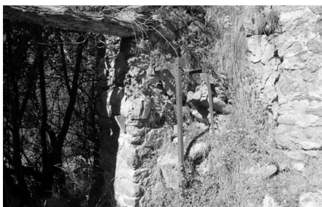
Soportes para el cuadro de control — 2017
