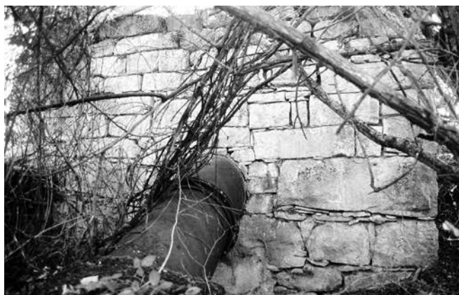
Cubo con tubo de suministro para turbina — 2007
