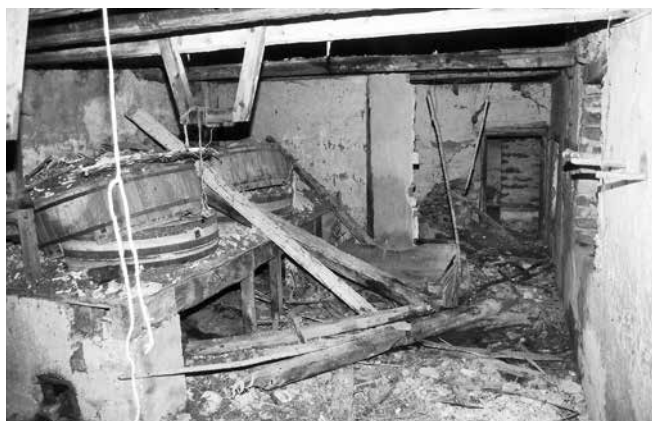
Espacio de trabajo con acceso a la central
