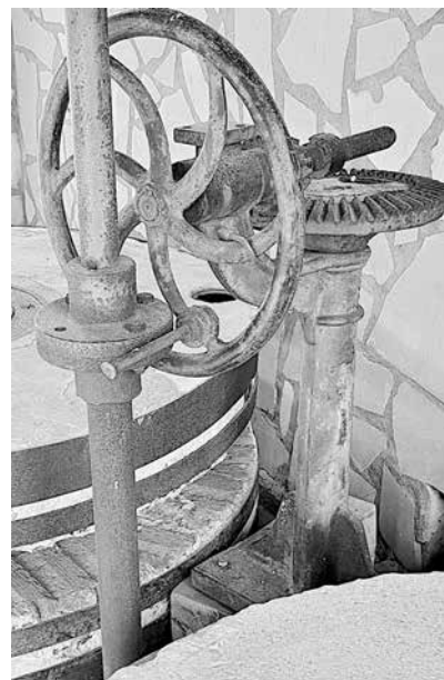
Regulador de la turbina - 10
